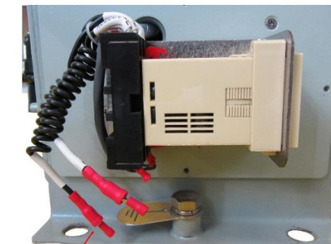
محل اتصال برق 220VAC برای هیتر
